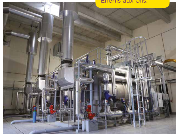
Chaufferie biomasse Enerlis aux Ulis.
